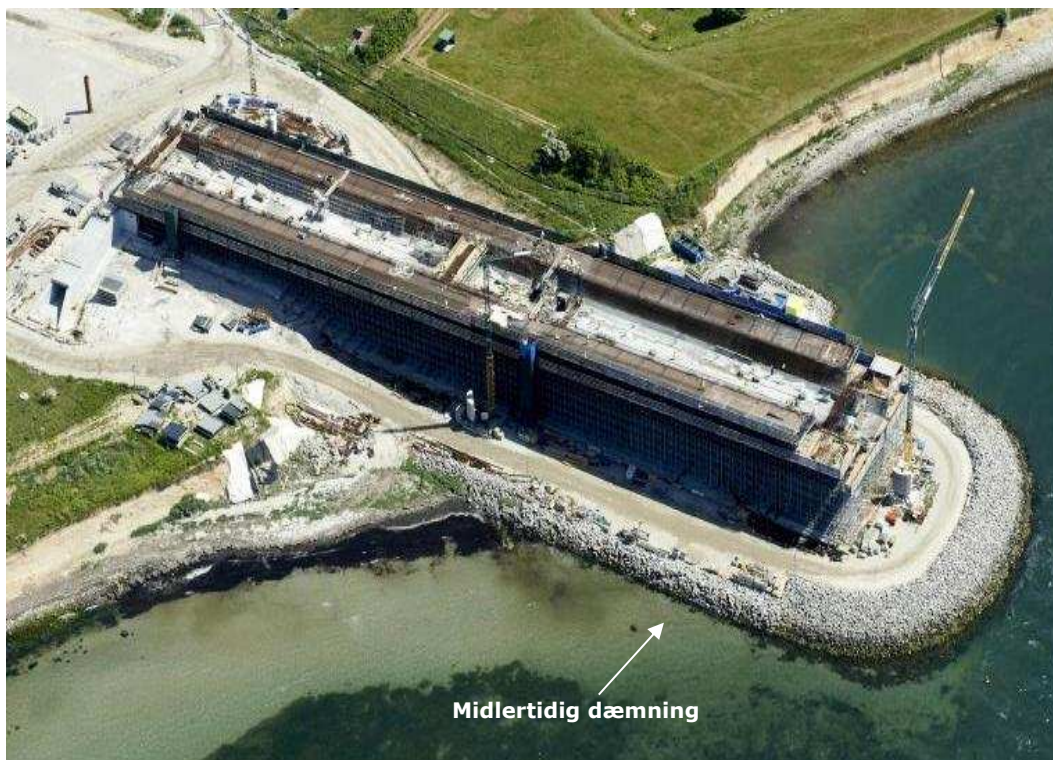
Figur 5-17 Eksempel fra Størstrømsbroen. De to første brofag fra Masnedø bygges på stedet – fremskudt på en midlertidig dæmning i anlægsfasen.
